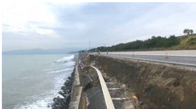
護岸及び道路崩落状況
