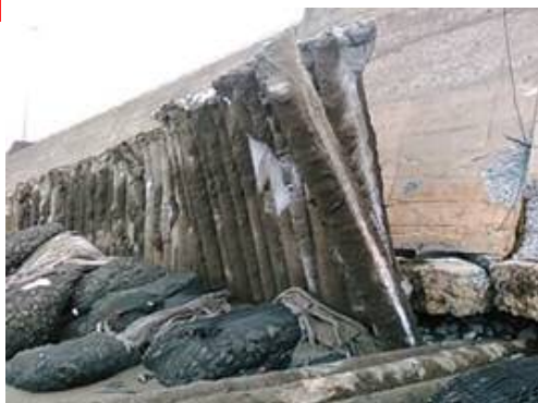
護岸擁壁洗掘状況
