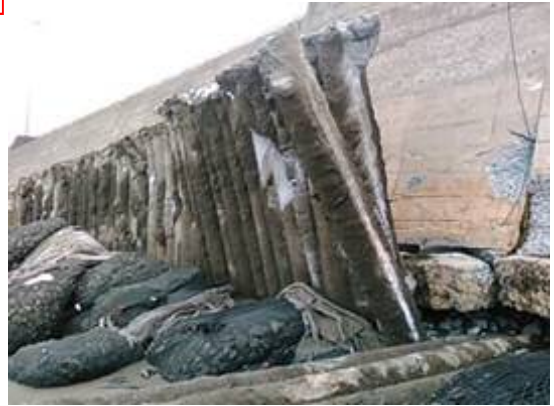
護岸擁壁洗掘状況
