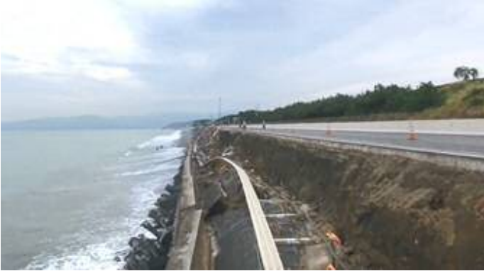
護岸及び道路崩落状況
