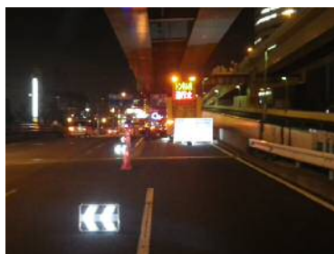
▲通行規制の状況(H28.6)
