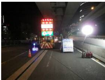
▲通行規制の状況(H27.12)
