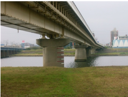
橋脚補強施工前
