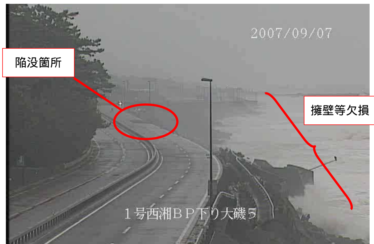
西湘バイパスにおける路面陥没、擁壁等欠損状況 (西湘二宮ICから大磯東方面を望む)
