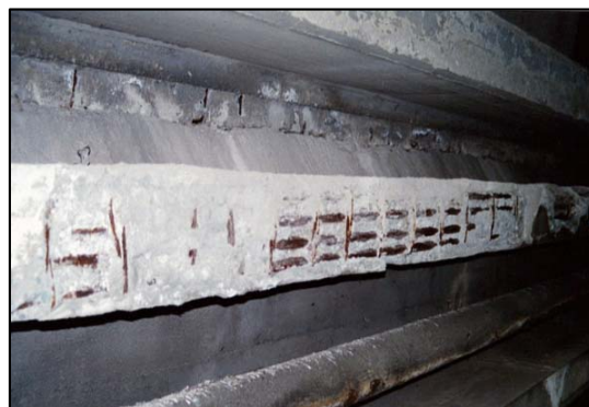
架け替え前の内川橋の主桁 (鉄筋の露出)
