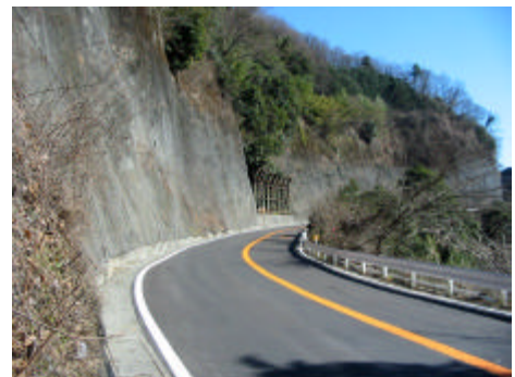
瀬戸地区 線形悪状況
