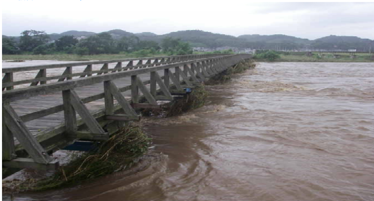
流水により佐野橋の橋桁がずれた。 ~ 群馬県高崎市上佐野 ~
