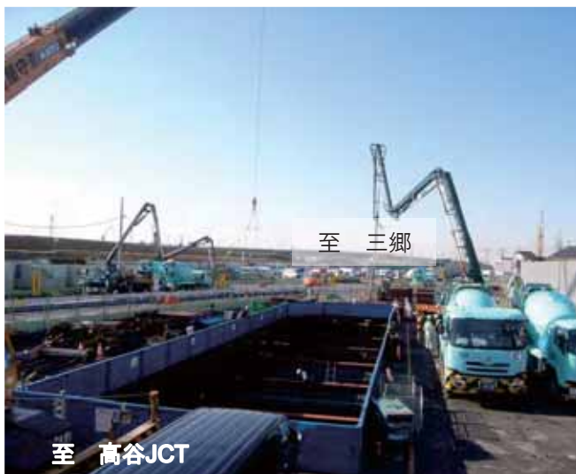
C いちかわ たじり ちく かんきょこうじ 市川市田尻地区函渠工事状況
