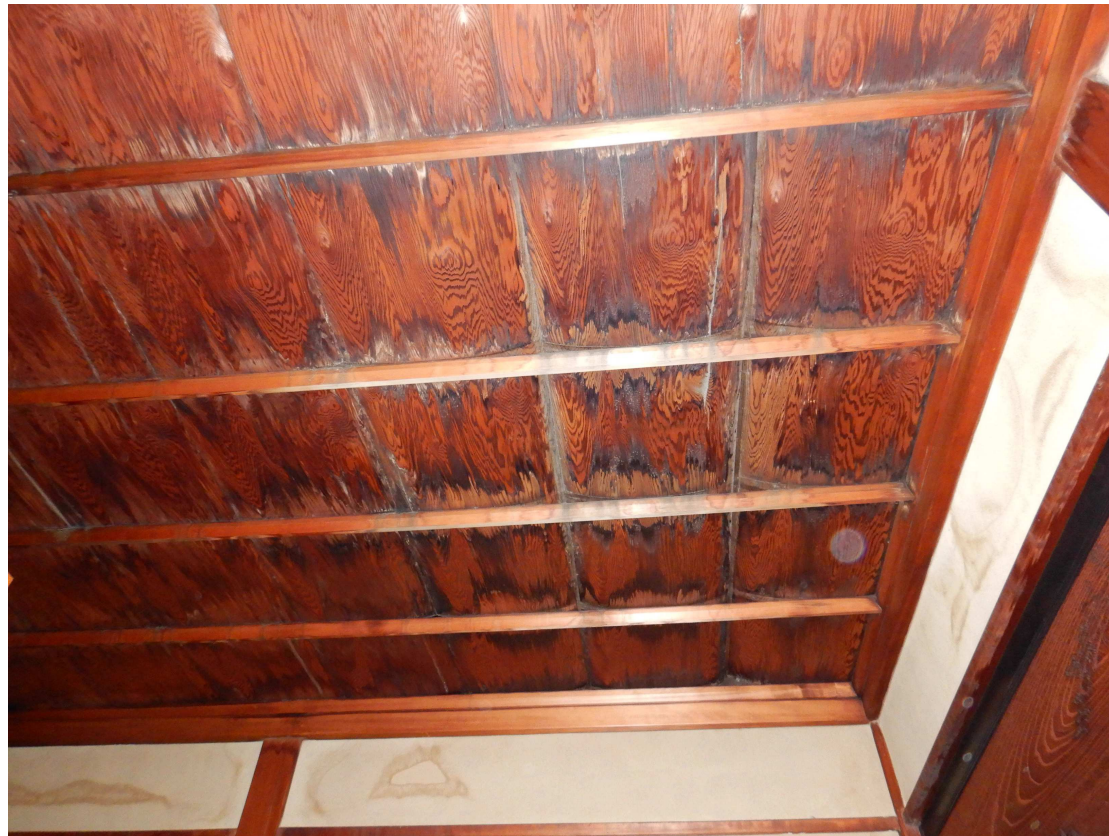
(1) 和室棟 御次 天井材の雨染み跡 ⇒清掃の上再利用、或いは取替 (洗いはしない方向で検討中)
