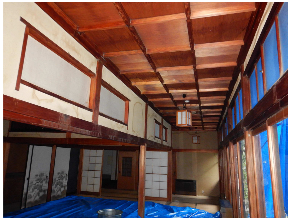
(2) 和室棟 広縁-1 天井材(突板)、長押、鴨居の雨染み跡 ⇒清掃の上再利用、或いは取替 (洗いはしない方向で検討中)
