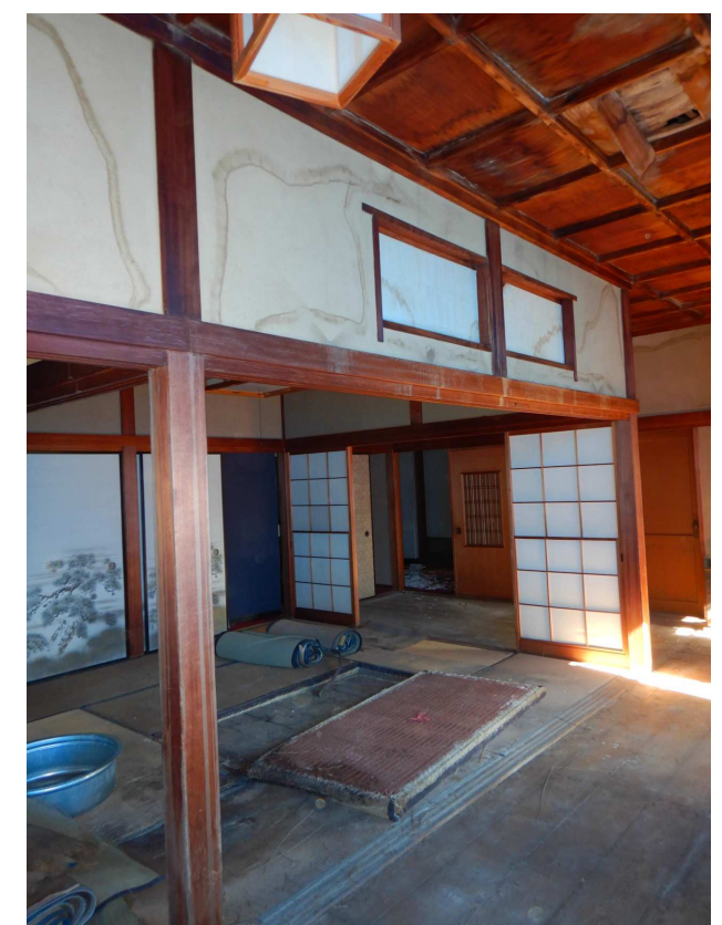
(3) 和室棟 広縁-1 柱、天井板(突板)、長押、鴨居の雨染み跡 ⇒清掃の上再利用、或いは取替 (洗いはしない方向で検討中)
