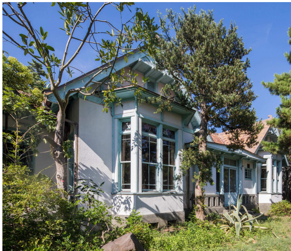
(4) 洋室棟南面外壁 造作材への塗装の剥落⇒活膜を残し、当初色を上塗り予定 外壁吹付材(後補)の剥落⇒剥離方法検討中
