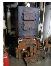
写真 46 アサヒボイラー (2019 年撮影)
