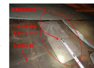
写真 36 北側屋根に残るスレート材（2019 年撮影）
