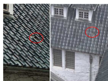
写真 43 一部落下した屋根瓦 (2019 年撮影)
