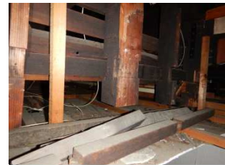
写真 32 間仕切り改造による柱切断（2019 年撮影）
