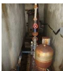
写真 42 ポンプ室内 (2019 年撮影)
