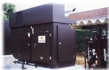
非常用発電機 非常時に自動的に作動
