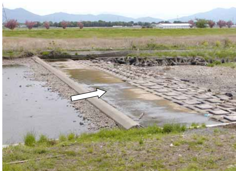
瀬切れの状況(平成17年5月19日撮影) 八田堰下流
