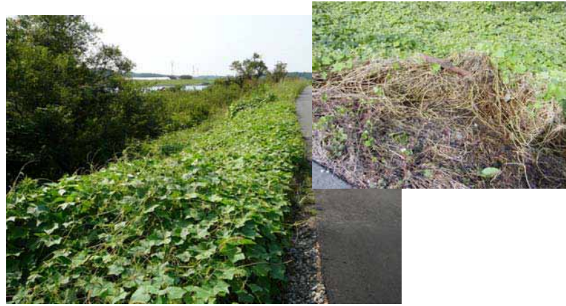
堤防の機能低下 (アレチウリの繁茂による堤防法面の一部裸地化状況)
