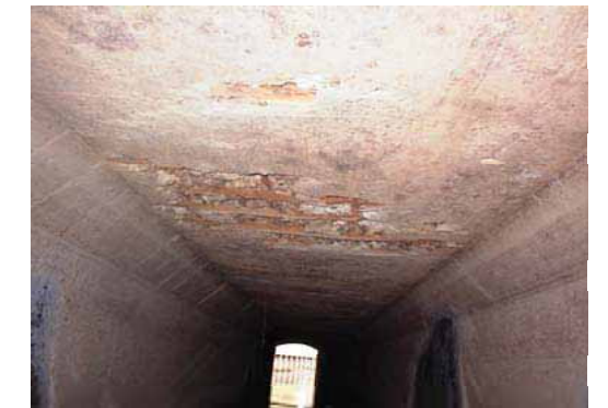
コンクリートが劣化し 鉄筋が露出した樋管の内部
