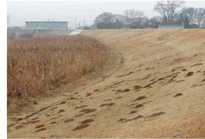
巡視で発見された堤防のモグラの巣
