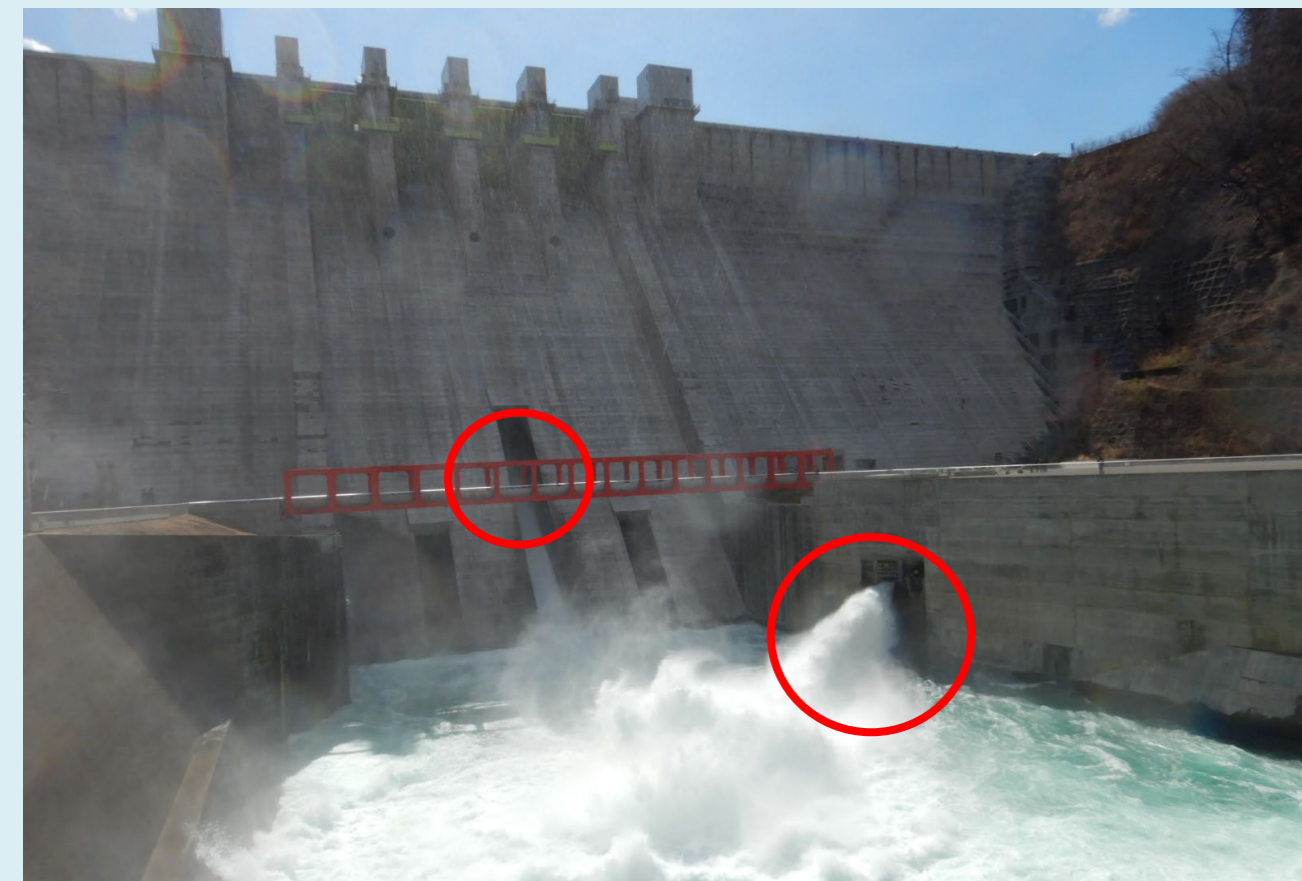
ダム名：ハッ場ダム 放流ゲート：利水大容量放流設備ゲート (右側) 水位維持用放流設備ゲート (左側)
