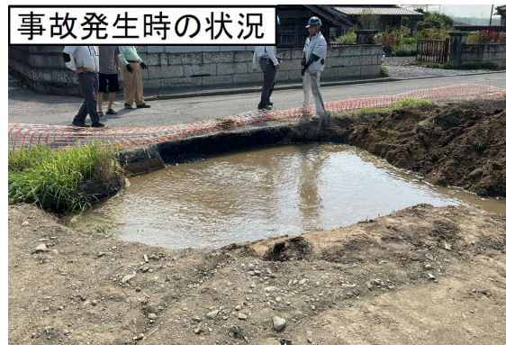
断水後の状況
