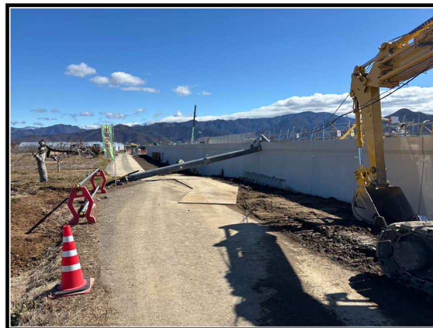
事故発生直後の電柱等損傷状況
