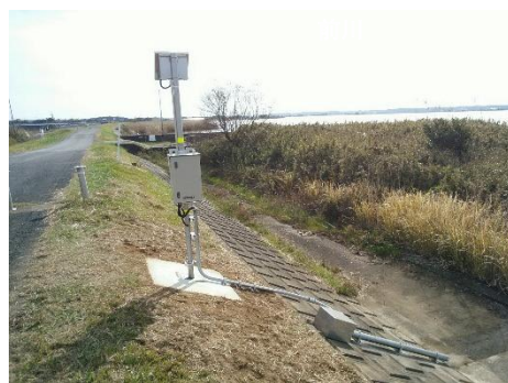
神栖下幡木地先 水位計設置
