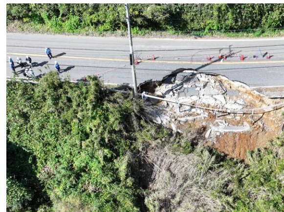
被災状況調査(千葉県袖ヶ浦市)
