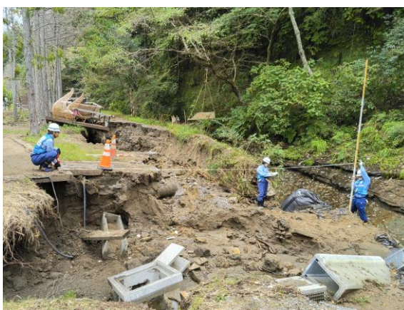
被災状況調査(千葉県君津市)
