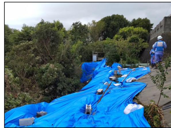
被災状況調査(神奈川県横須賀市)
