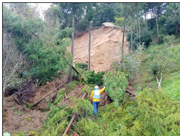
被災状況調査(千葉県山武市)
