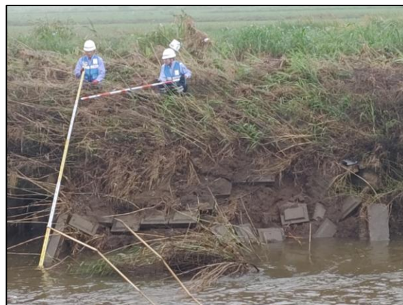
被災状況調査(千葉県佐倉市)
