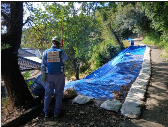
被災状況調査(千葉県東金市)
