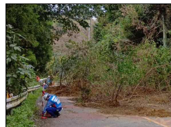
被災状況調査(千葉県袖ヶ浦市)
