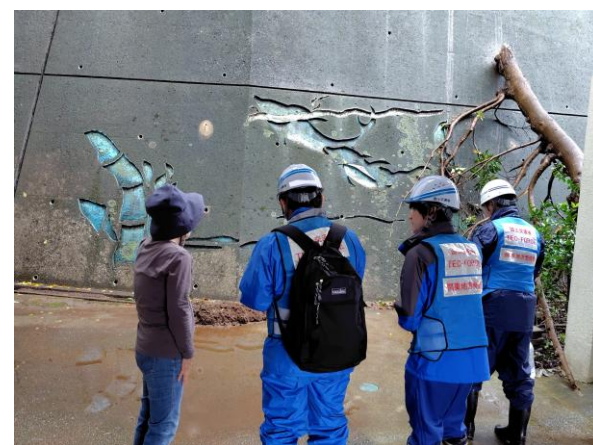
被災状況調査(神奈川県三浦市)
