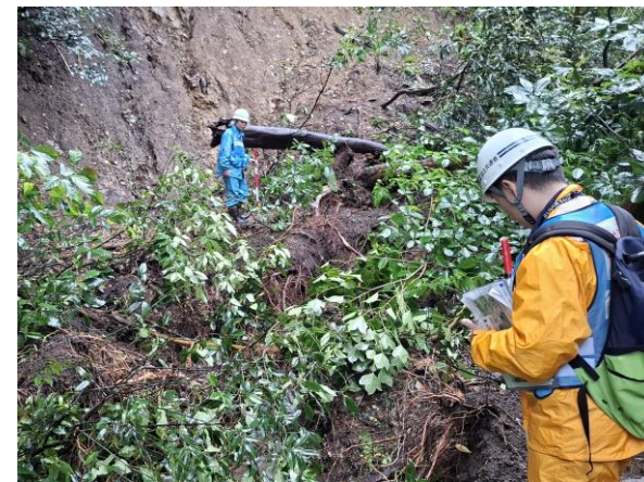
被災状況調査(神奈川県横須賀市)
