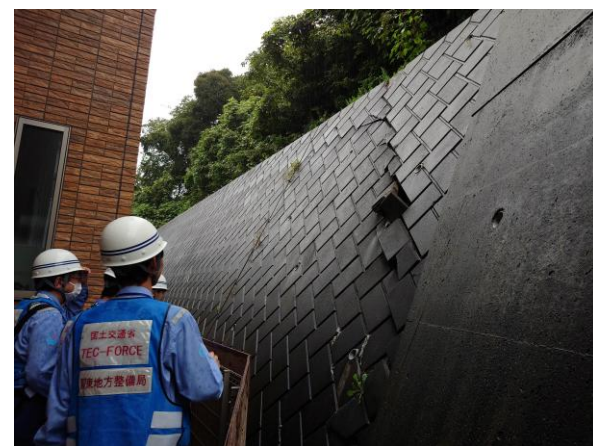
被災状況調査(神奈川県横須賀市)
