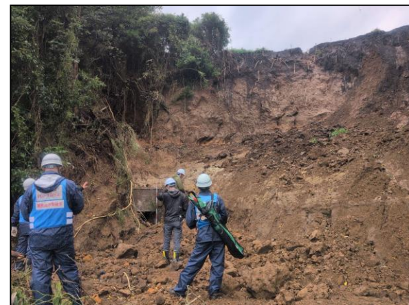
被災状況調査(神奈川県横須賀市)
