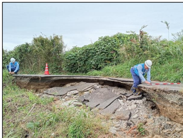
被災状況調査(千葉県印西市)
