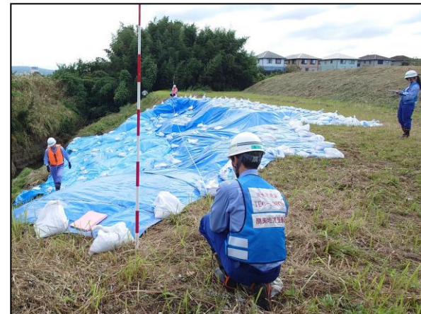
被災状況調査(千葉県君津市)
