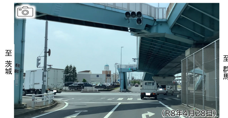
▲対策前の状況
