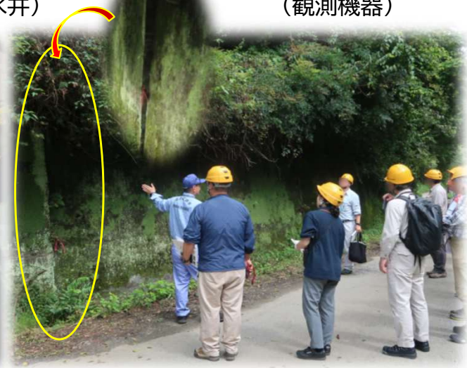
地すべり災害(H3)時の変状状況説明 (道路擁壁工のズレ)
