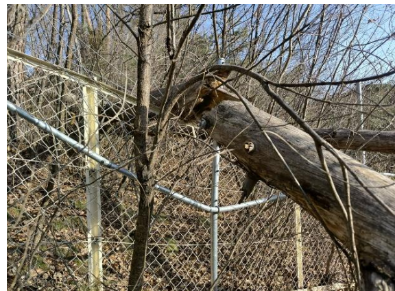
2025 年3月 中部横断道(佐久市内) 私有地からの倒木による立入防止柵の破損
