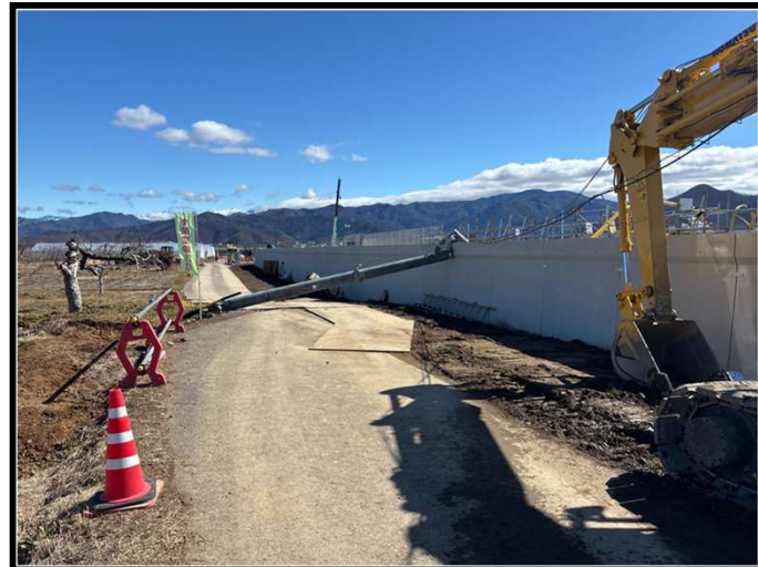
事故発生直後の電柱等損傷状況
