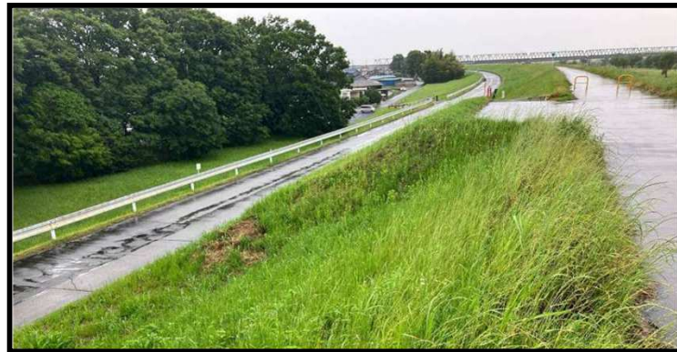
事故発生地点写真
