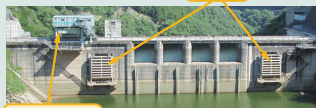
ガントリークレーン (予備ゲート開閉装置)
