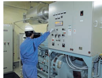
電気通信設備の点検 (予備発電機)
