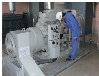
電気通信設備の点検 (予備発電機)
