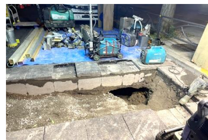
【開削状況（空洞状況）】
