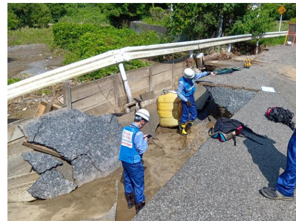
被災状況調査(八街市)
