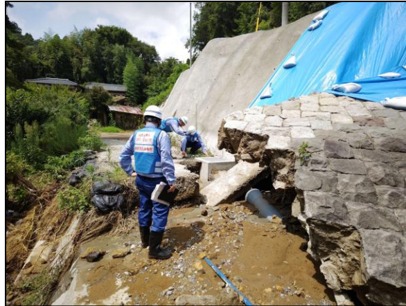
被災状況調査(千葉市)
