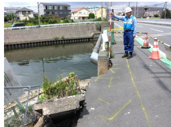
被災状況調査(千葉市)
