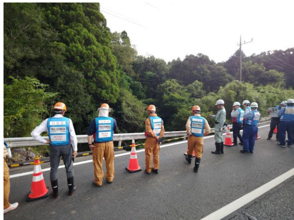
(一社)日本建設業連合会との緊急復旧に向けた 現地調査(市原市)
