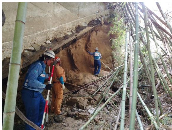
応急復旧支援に向けたTEC-FORCEパートナーと被災状況調査(市原市瀬又)
