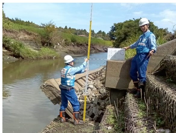
被災状況調査(大網白里市)
