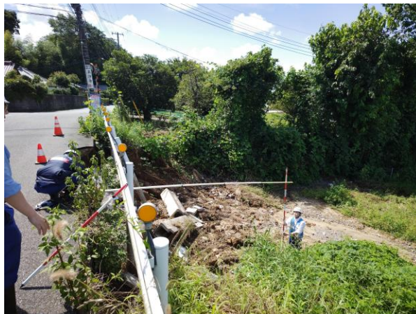
被災状況調査(千葉市)
