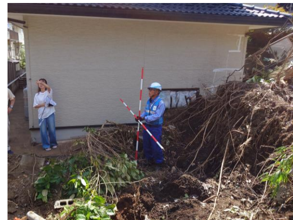
被災状況調査(四街道市)
