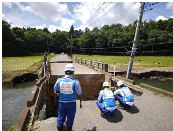
被災状況調査(千葉市)
