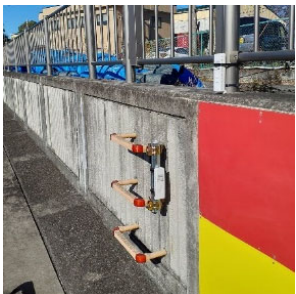
河川浸水センサ設置状況
