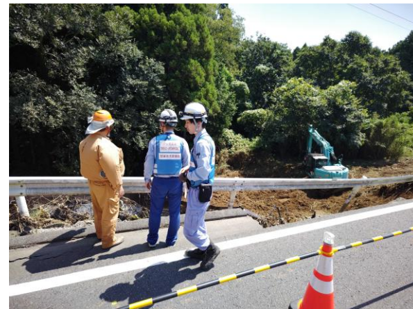
応急復旧支援状況(市原市瀬又)
