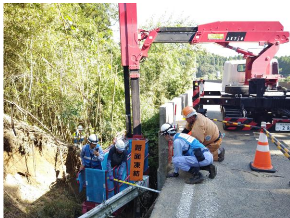
橋梁点検車による被災状況調査(市原市)
