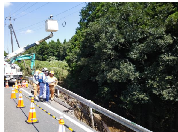
応急復旧支援状況(市原市瀬又)
