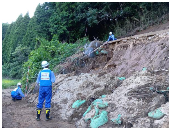
被災状況調査(千葉市)
