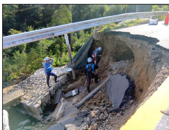
被災状況調査(千葉市内)
