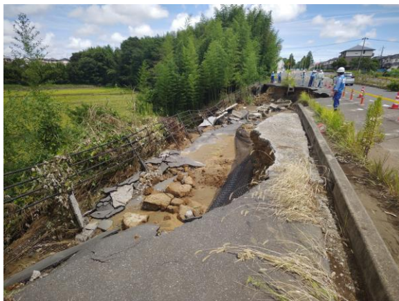
千葉市内の被災状況調査
