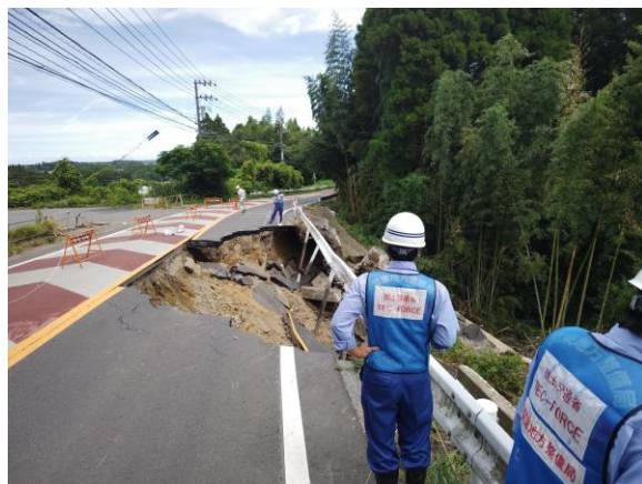
千葉市内の被災状況調査
