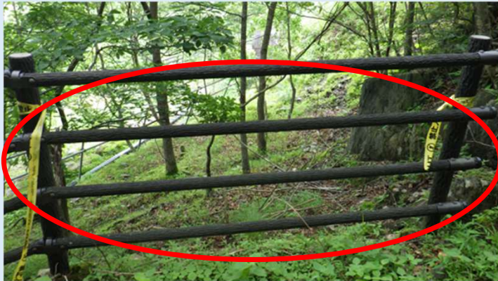
対策前 注意喚起テープが破損している
