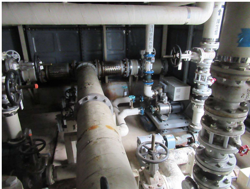
同 ポンプ室内
