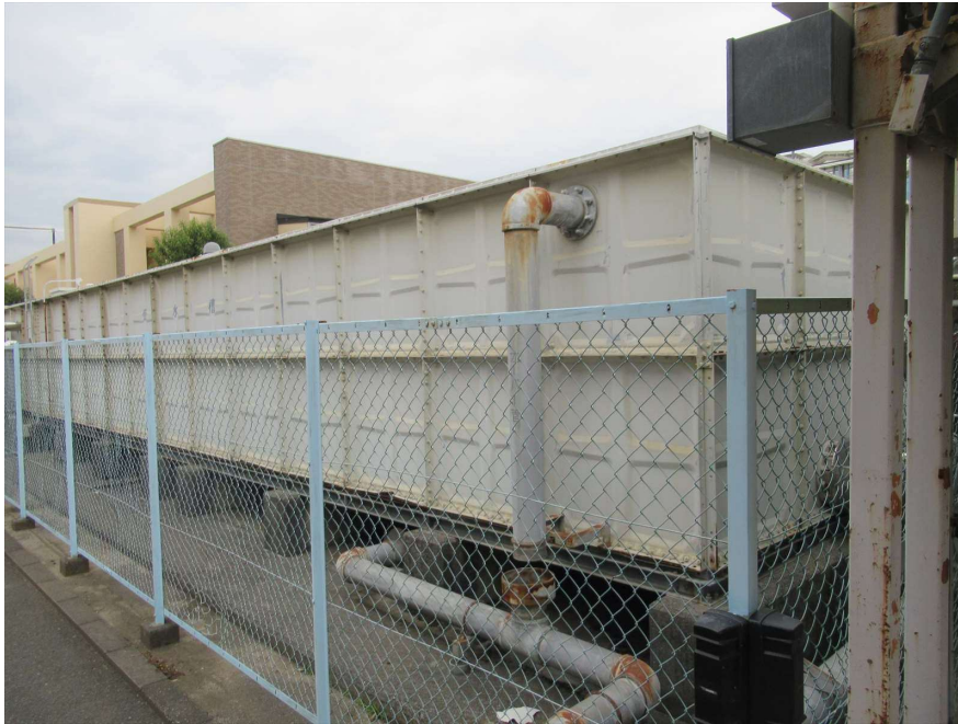
既存ポンプ室付受水タンク
