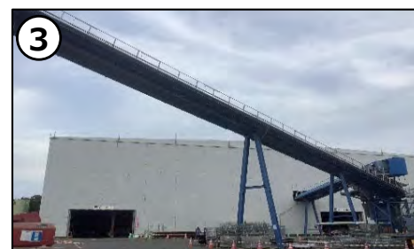
③-1 発進立坑地上設備(R4.10時点)
