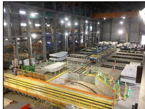
③-2 発進立坑地上設備内部(R4.10時点)
