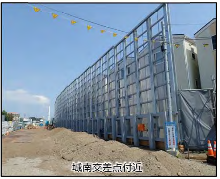
<遮音壁の設置状況>
