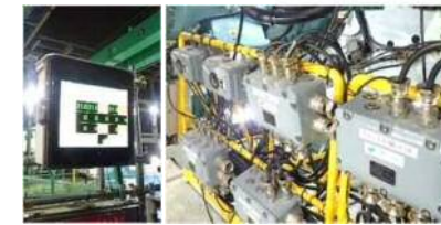
①ガス監視モニター(左)・ガス検知器システム(右)
