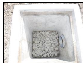
雨水貯留浸透枡整備事例（昭和町）
